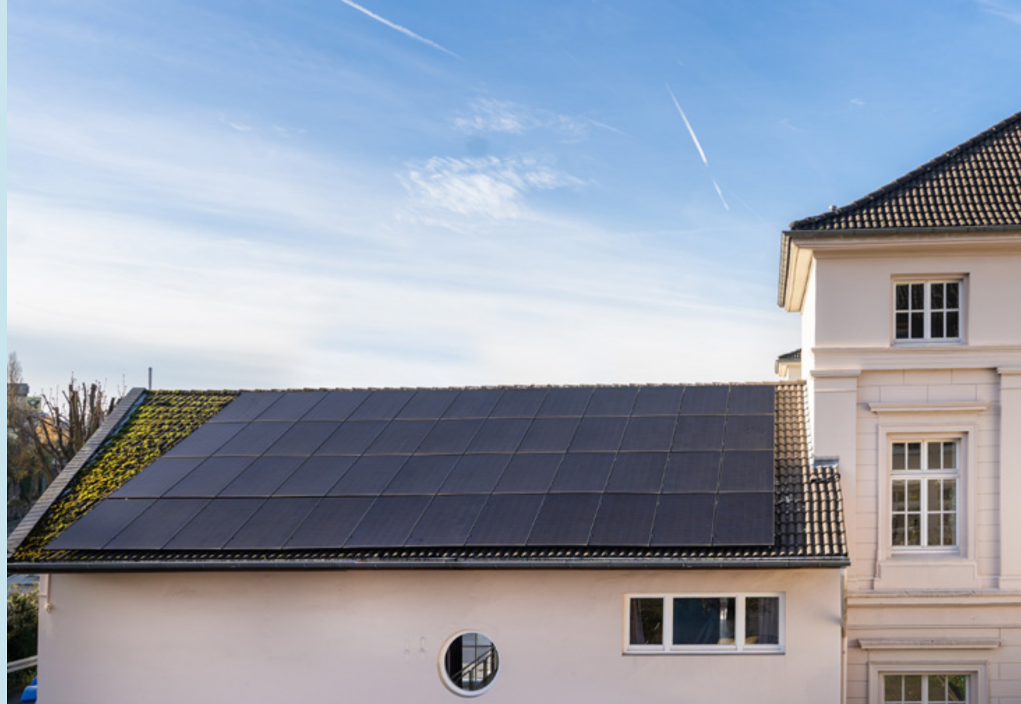
Photovoltaikanlage auf dem Institutsdach der Aula am Döppersberg in Wuppertal
